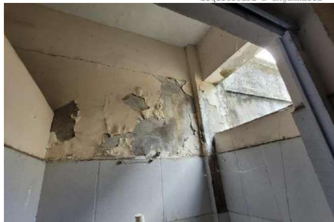
Figura 24 – Parede banheiro pavimento térreo
